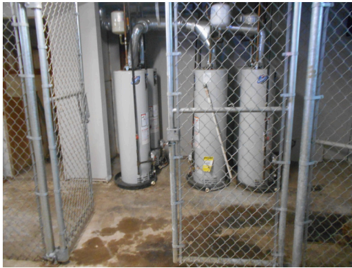
Tenant water heaters
