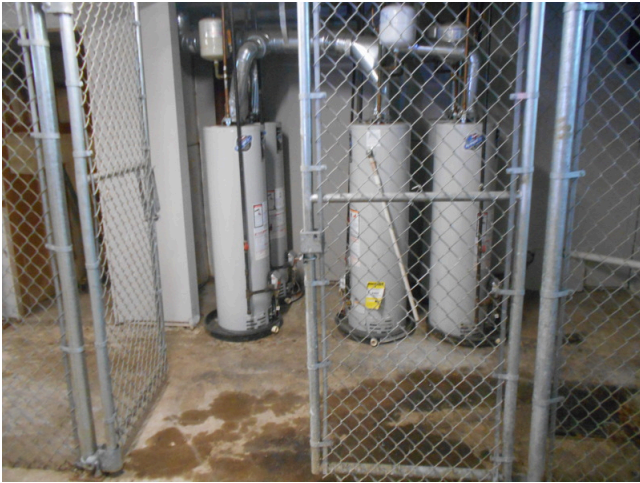
5. Tenant water heaters
